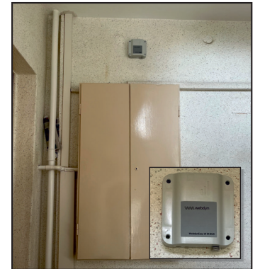
Installiertes Gateway in einem Treppenhaus
